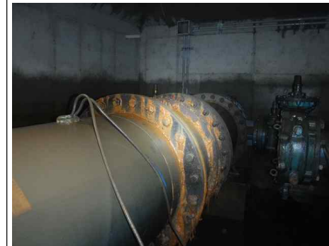
배관 및 밸브 상태
