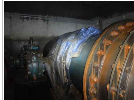
배관 및 밸브 상태
