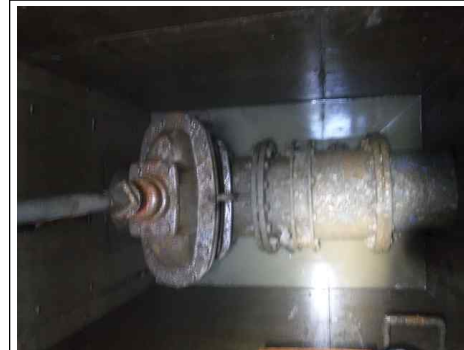
배관 및 밸브 상태
