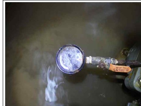
수압계 작동상태 양호
