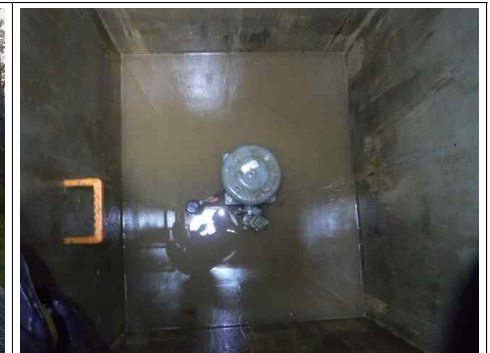
밸브실 내부 전경
