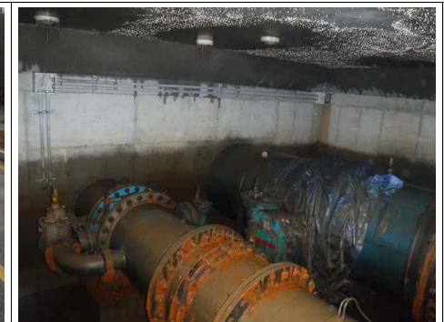
밸브실 내부 전경
