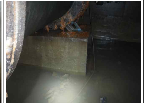
밸브 받침콘크리트 상태
