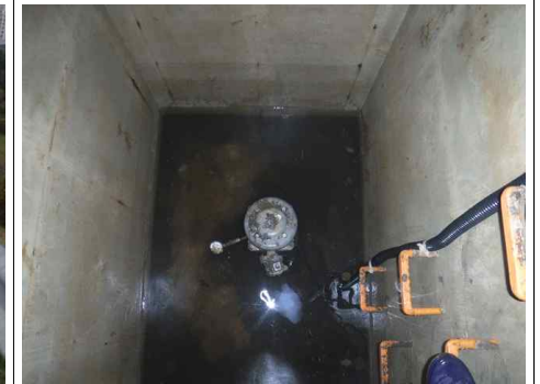
밸브실 내부 전경
