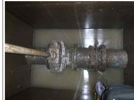
배관 및 밸브 상태
