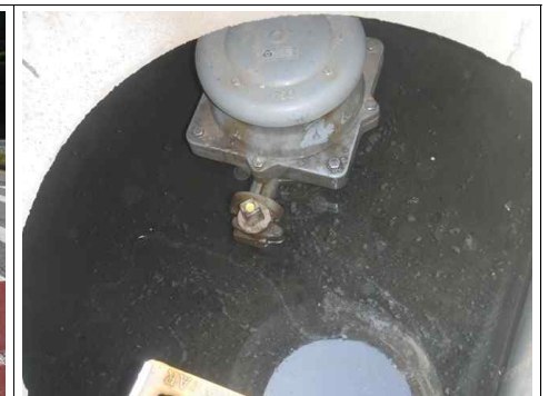
밸브실 내부 전경
