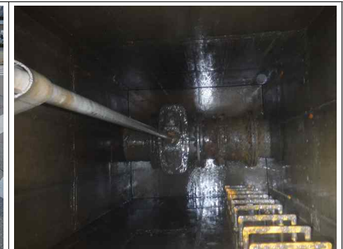
밸브실 내부 전경
