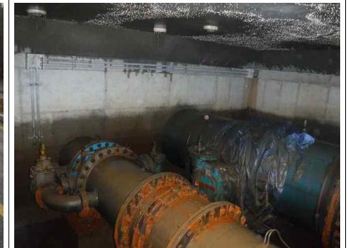
밸브실 내부 전경
