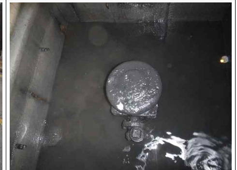
밸브실 내부 전경
