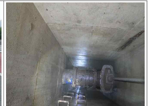
밸브실 내부 전경
