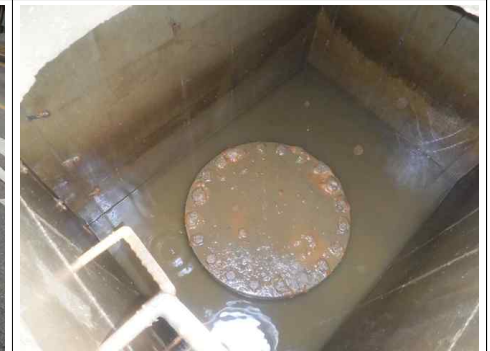
밸브실 내부 전경
