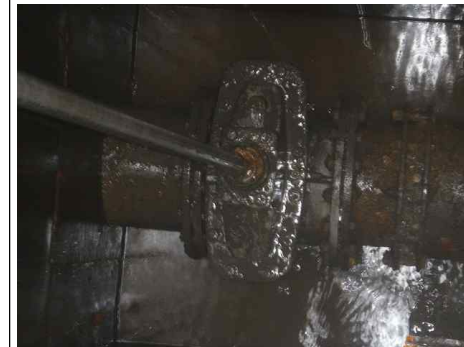
배관 및 밸브 상태
