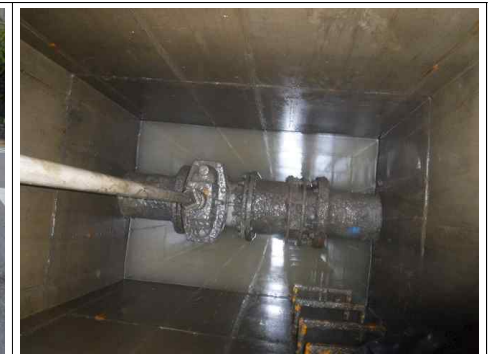
밸브실 내부 전경
