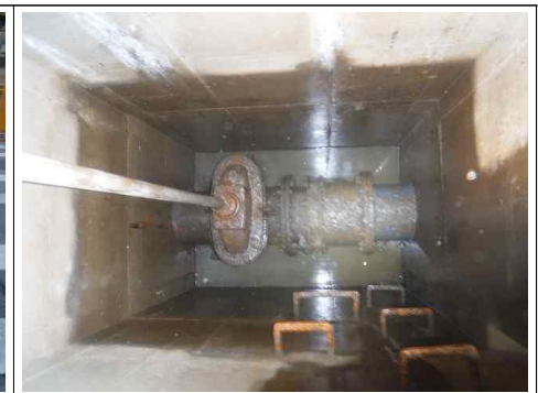
밸브실 내부 전경
